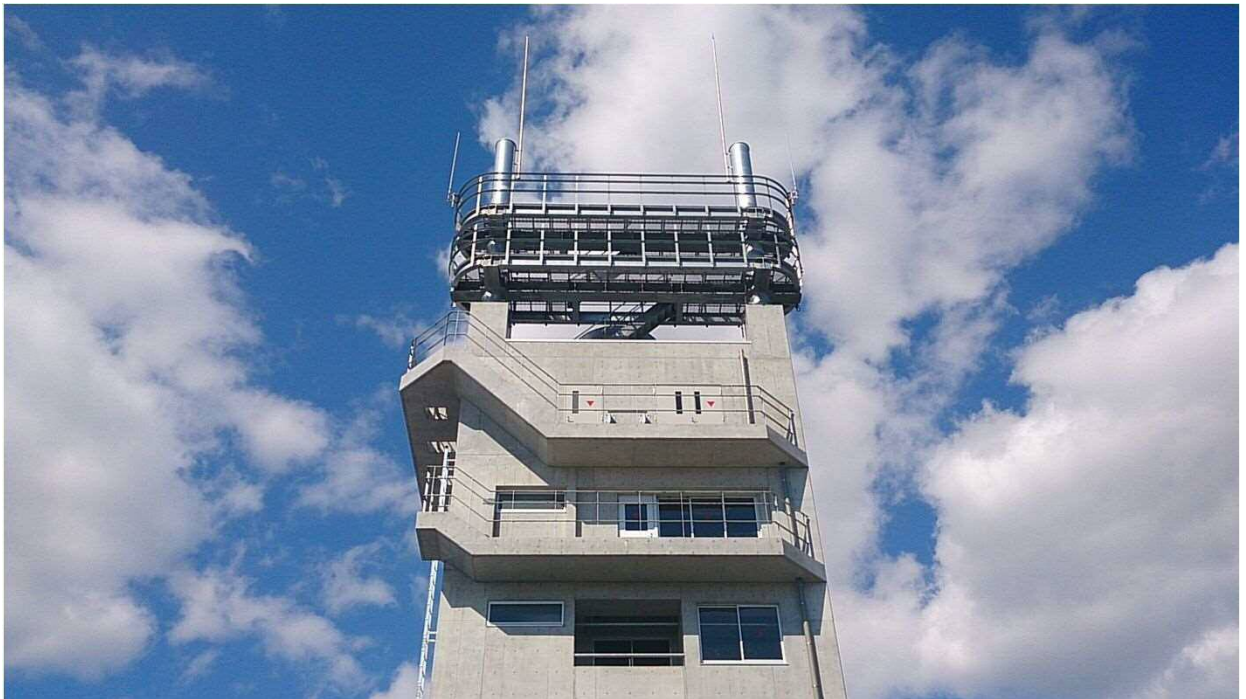
訓練塔最上階に設置されたデジタル無線アンテナ
